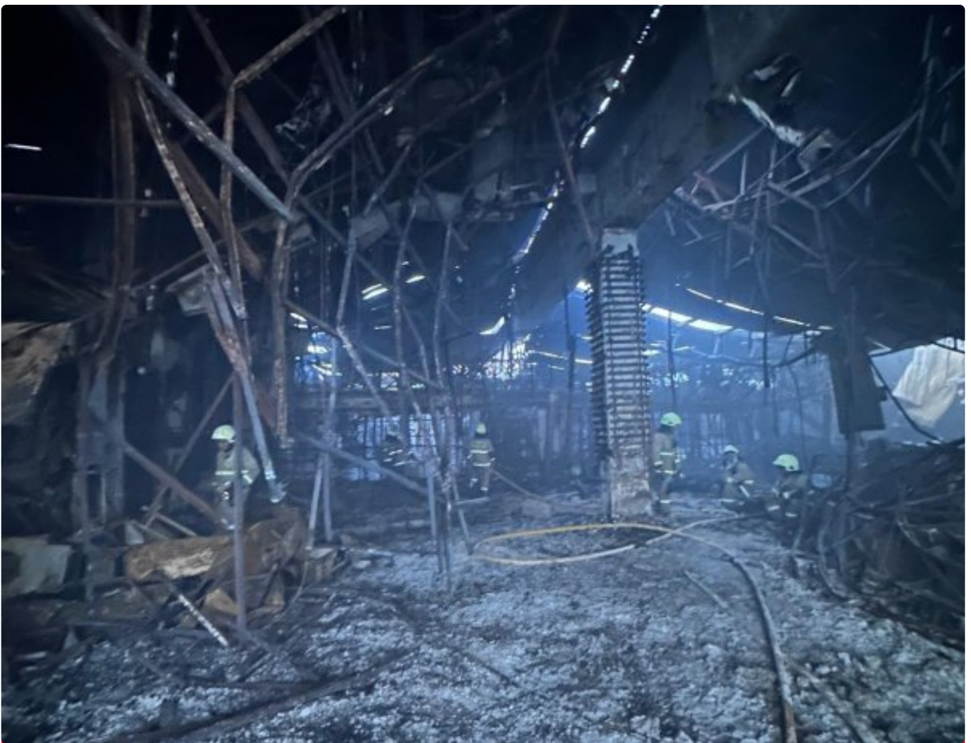
Glodok Plaza yang Hangus Terbakar
